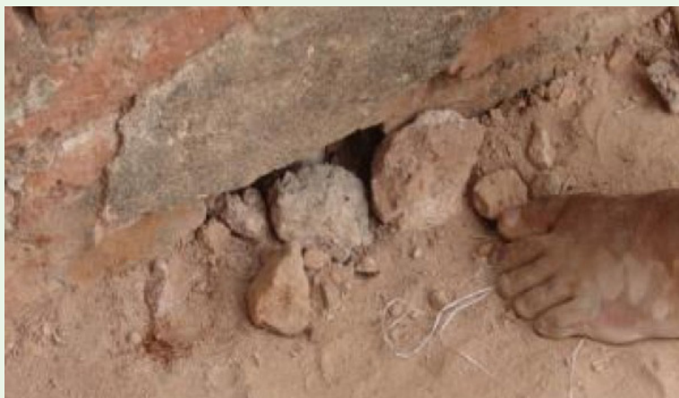
سوراخ هایی در سیستم ضد آب سقف یک پاگودا در باگان، میانمار، ۲۰۱۶. تصویر: نیوجینی کریتی
